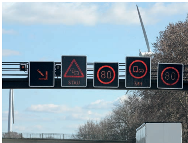
Elektronische Anzeigetafel auf Autobahnen
