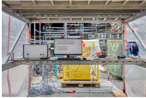
05_Sonnensegel Dortmund von Günter Behnisch: Kontrollpanel für Messungen am Bauwerk. Foto: Hans Jürgen Landes / Wüstenrot Stiftung
