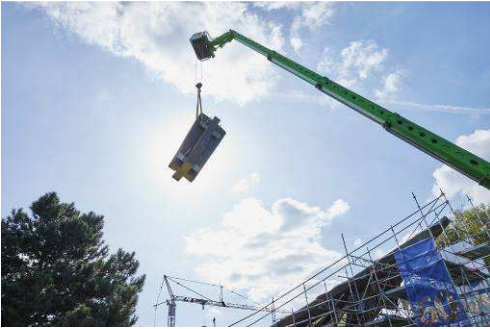
04_Sonnensegel Dortmund von Günter Behnisch: Ausbau eines Teilstücks einer defekten Holzstütze. Foto: Hans Jürgen Landes / Wüstenrot Stiftung
