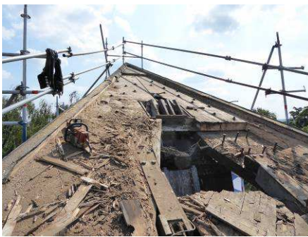
03_Sonnensegel Dortmund von Günter Behnisch: Freigelegte Holzmembran mit entfernten schadhafte Bereichen. Foto: Thomas Knappeide / Wüstenrot Stiftung
